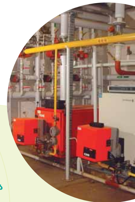
Chaufferie gaz naturel
